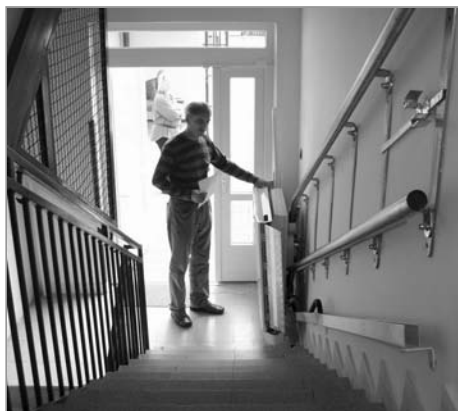
Schodišťová plošina pro odsouzené na vozíčkách v Břeclavské věznici.
