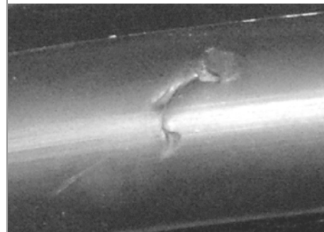
Trhlina č. 2 po přebroušení. Opravena byla až po delším čase – jsou proto patrné tvarové změny a zaoblené hrany potřhaných částí.
