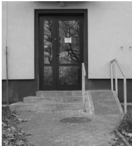
Pohled na nájezd pro kočárky s nevyhovující šířkou
